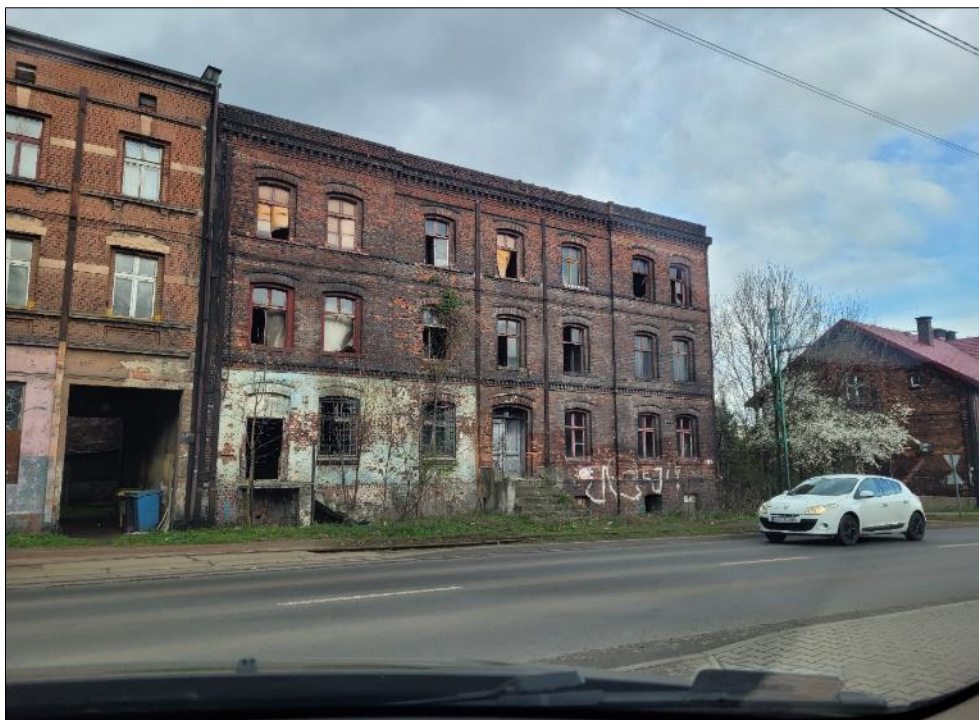
FOTOGRAFIA 2. WIDOK NA UL. ŚLĄSKĄ – KAMIENICA W ZŁYM STANIE TECHNICZNYM
