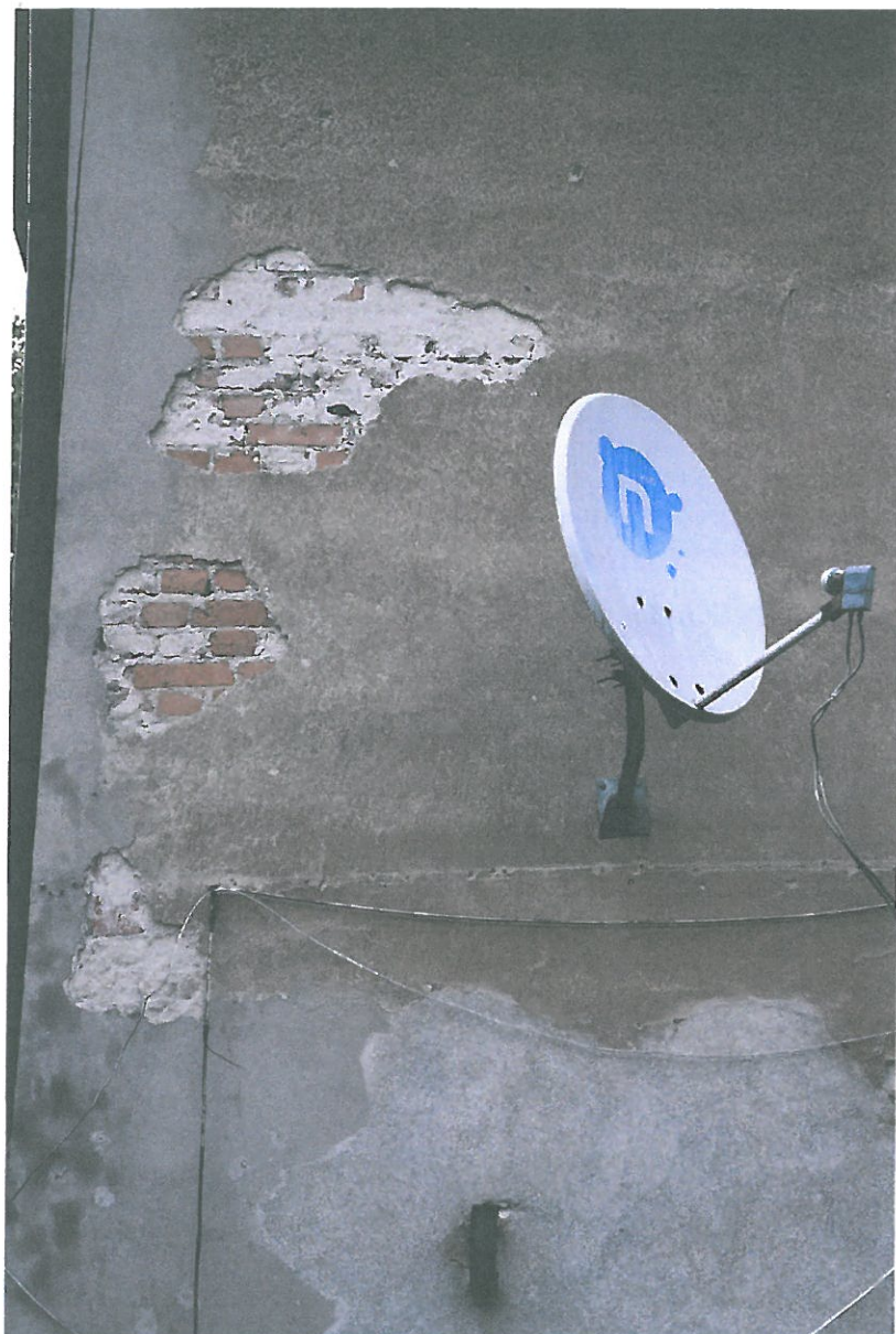
Przykłady ubytków elewacji
