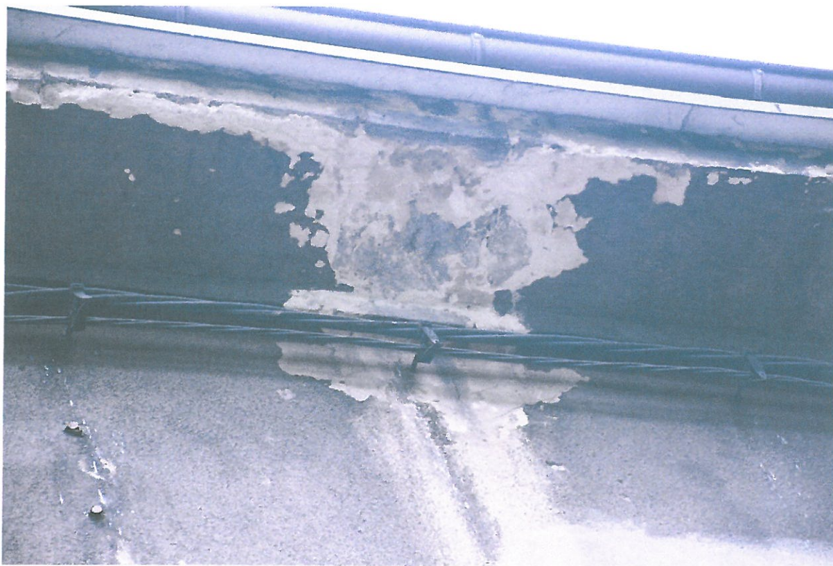
Przykład przeciekającego orynowania
